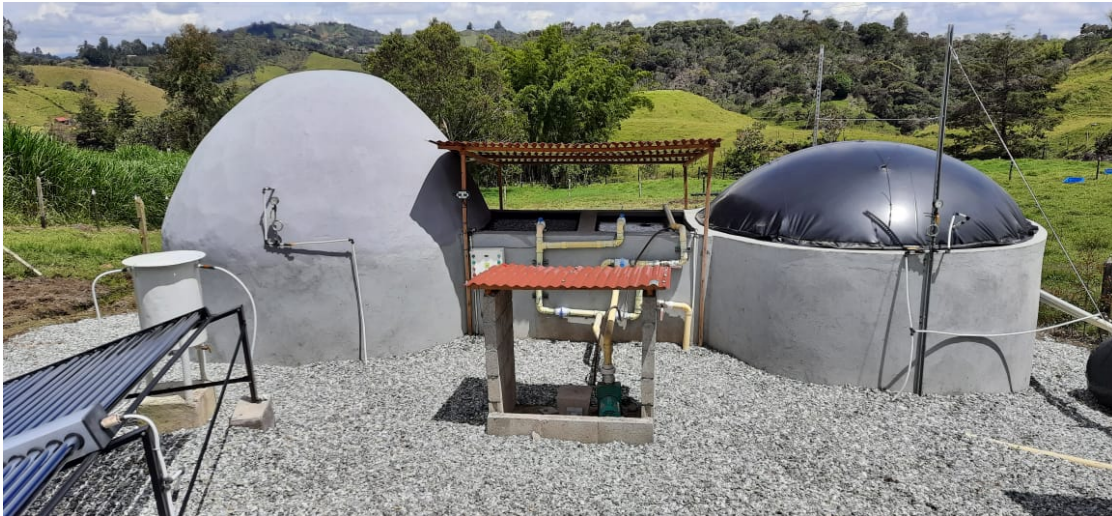
Foto: Esta es la planta que implementa el reactor UASB para la generación de energía/ Universidad CES.
